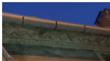
Imagen 74: Ejemplo de humedades en la cara inferior del alero
