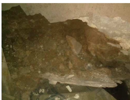
Imagen 86: Desconchado parcial de un muro de la vivienda
