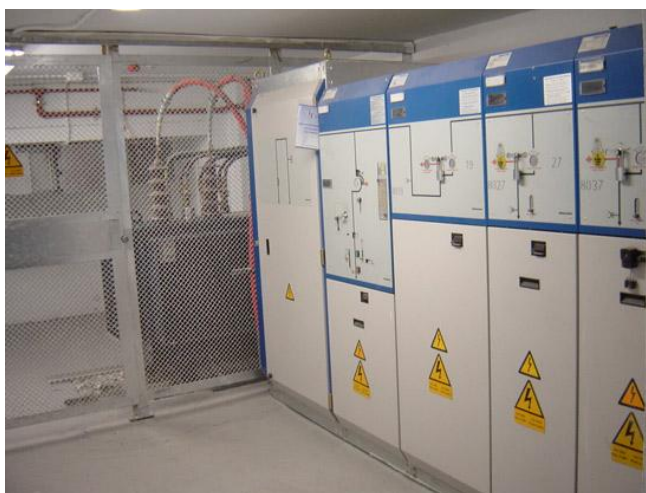
Foto 3. Interior de un centro de transformación.
