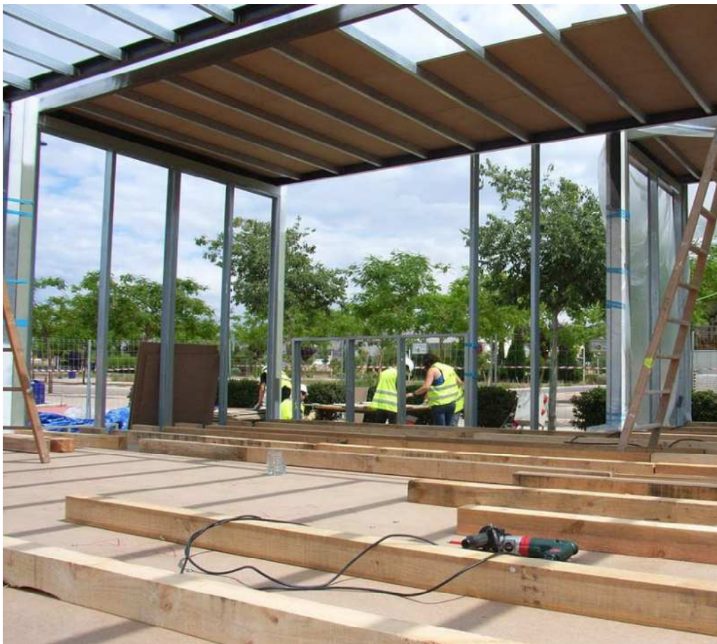
Ilustración 23 vista interior de los módulos durante el montaje; Fuente: eBRICKhouse project manual
