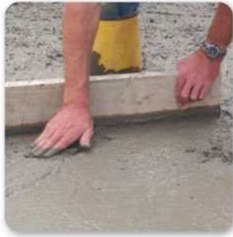
Ilustración 64 Trabajador aplicando hormigón si protección adecuada; Fuente: cdc.gov
