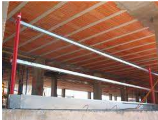
Ilustración 58 Barandilla de protección; Fuente: www.jeypesa.com
