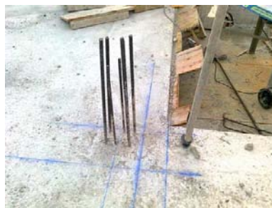
Ilustración 67 Error en la colocación de las esperas de pilar; Fuente: teoríadelaconstrucción.net
