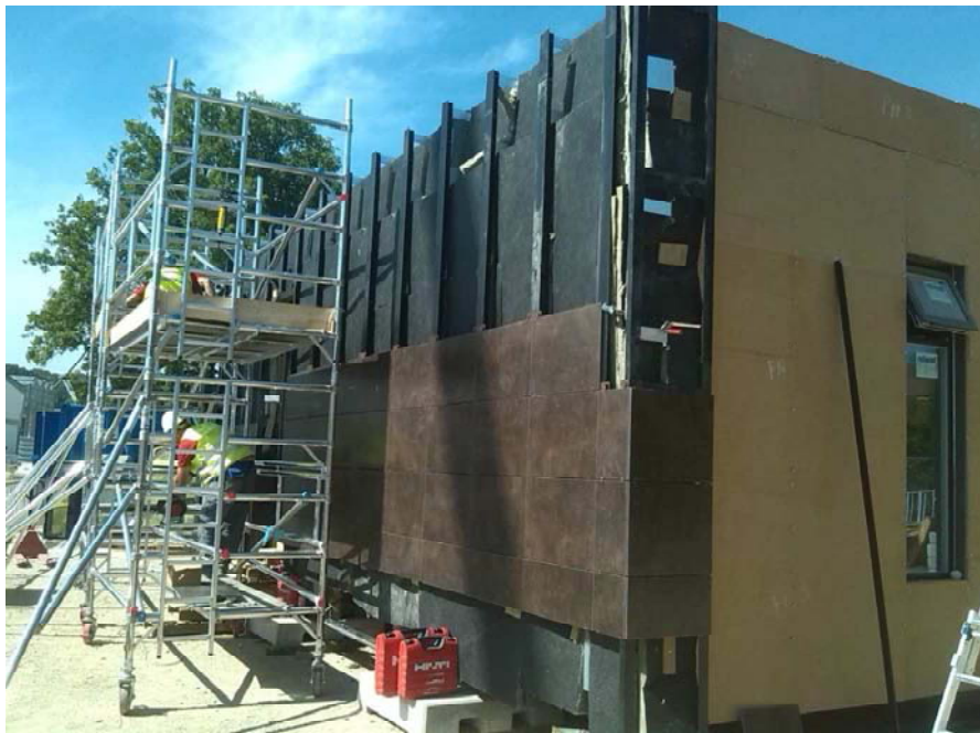
Ilustración 28 Montaje de la fachada ventilada durante el concurso; Fuente: eBRICKhouse project manual
