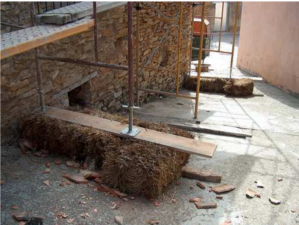
Ilustración 6: andamio con apoyo incorrecto.
