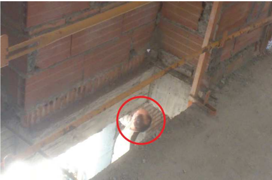
Ilustración 5: trabajador que le falta el casco.
