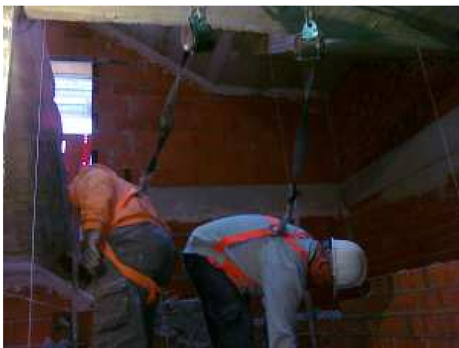
Ilustración 4: Trabajadores correctamente atados.
