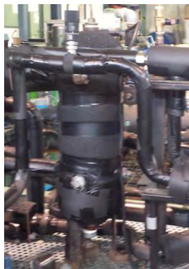
Ilustración 24. Depósito de expansión.
