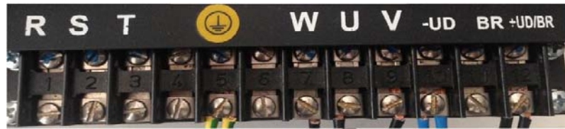
FIGURA 38 BORNEO DE POTENCIA DEL INVERSOR
