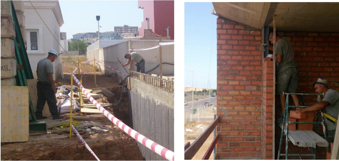
Fig. 64: Operarios realizando tareas prescindiendo de sus EPI's
