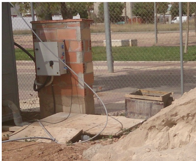
Fig. 60: Armario del cuadro eléctrico de la obra
