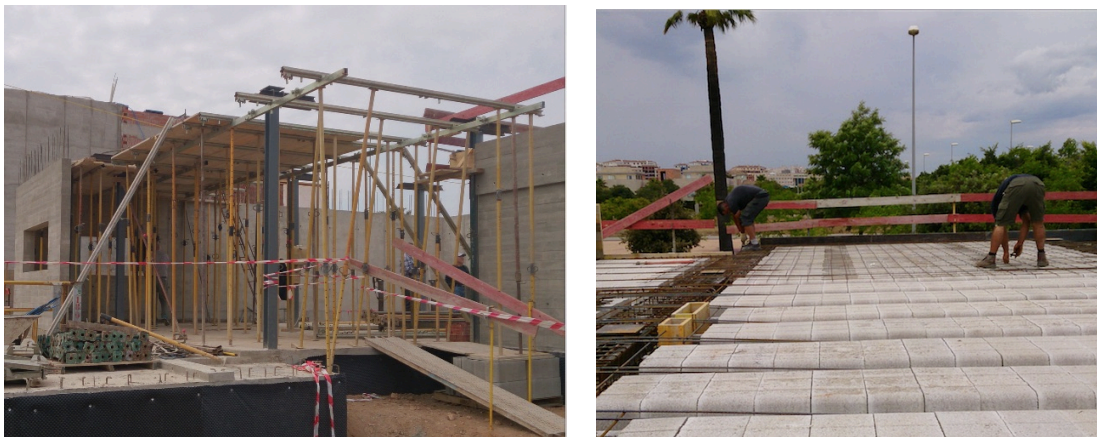
Fig. 66: Riesgos montaje de la estructura de 1ª Planta
