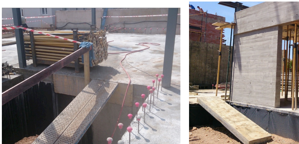
Fig. 50: Andamios y cajones de encofrado utilizados como pasarela de acceso a la obra
