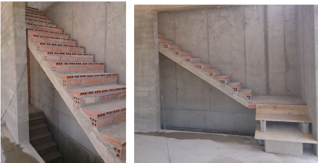
Fig. 65: Tramo de escaleras desprovista de barandilla provisional
