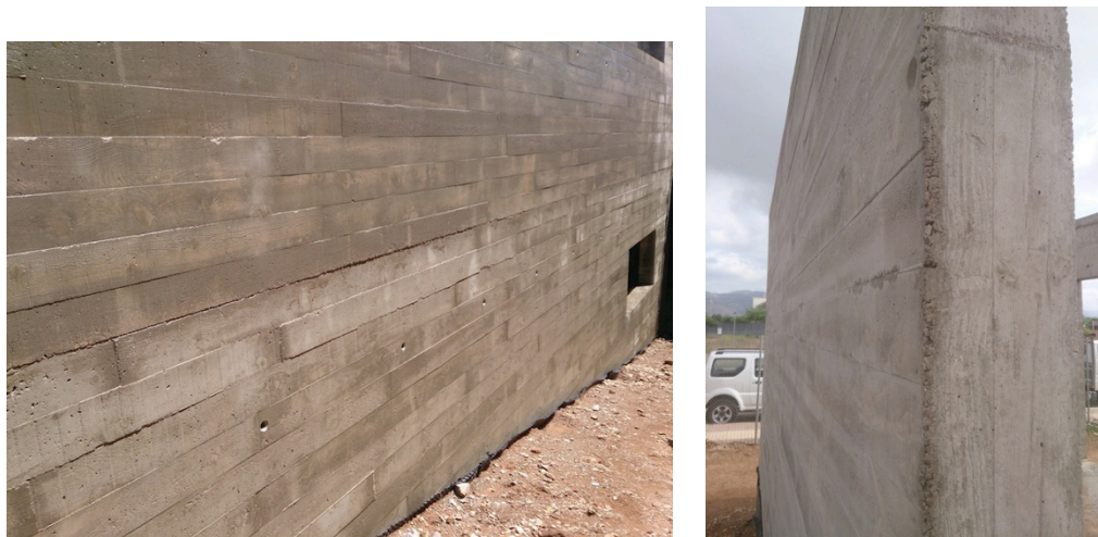
Fig. 49: Imperfecciones superficiales en fachadas de hormigón visto
