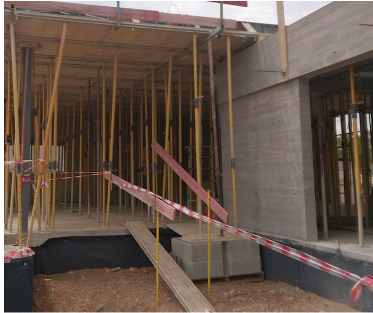
Fig. 45: Puntales de encofrado apoyados sobre un acopio de bloques de hormigón
