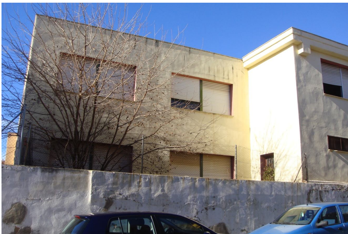
Fachada este con sur. Unión de antiguo colegio con residencia. A la derecha se observa el deterioro de las persianas del antiguo colegio en desuso
