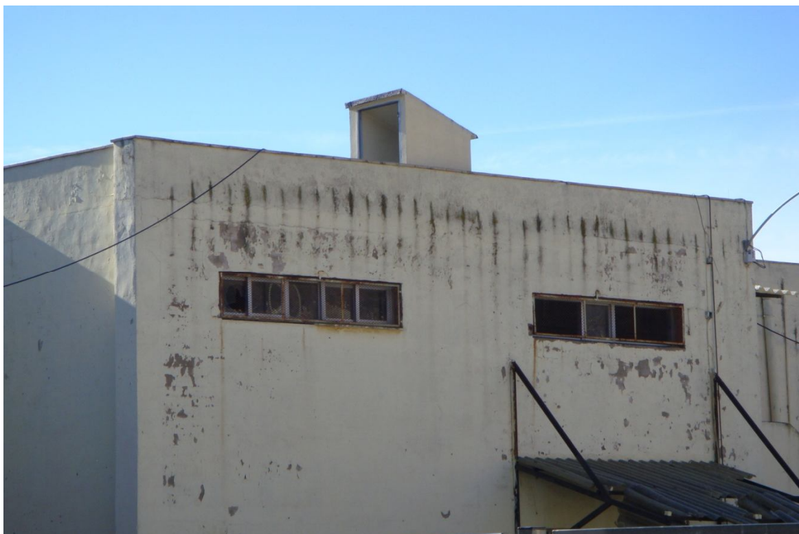
Fachada Norte. Desconchados de pintura y oxidación de la carpintería
