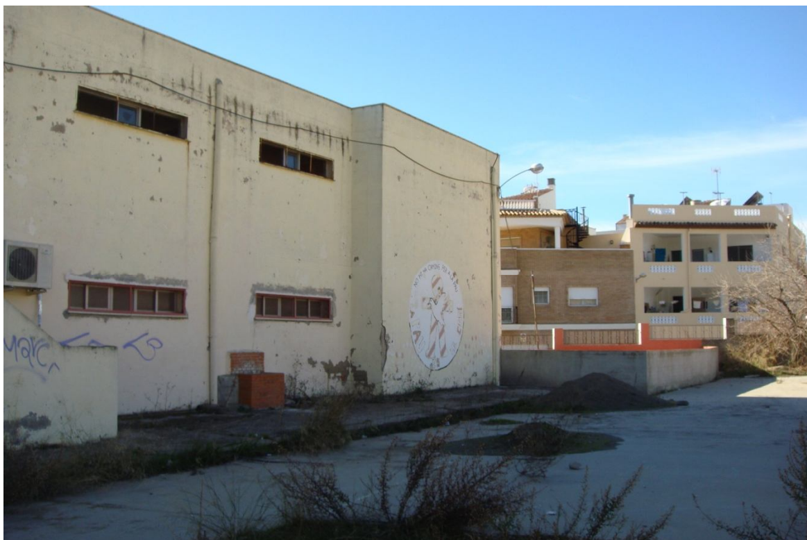
Fachada norte. Enfoscado deteriorado
