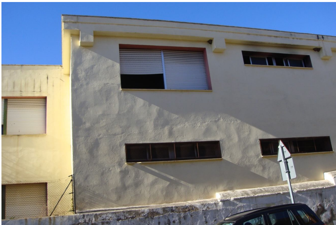
Fachada este. Se observa oscurecimientos en fachada por incendio
