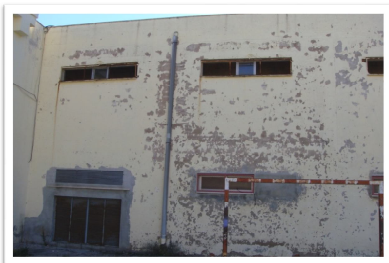
Imagen fachada cara norte donde se observa su deterioro y desconchamiento de la pintura.
