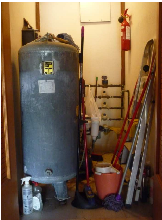
Figura 10.1.7 Cuarto Contadores y Grupo Presión
