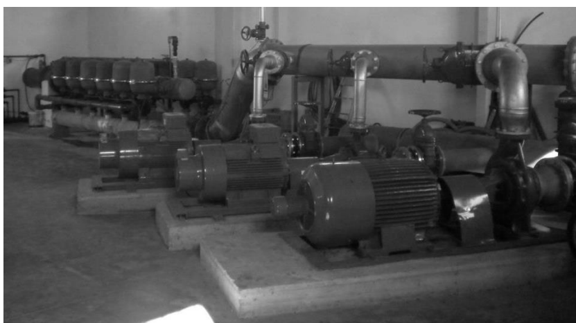
Figura 9. Sistema de bombeo de la agrupación A1
