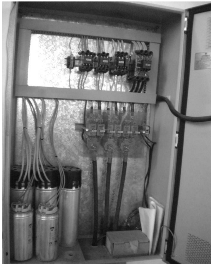
Figura 10. Batería de condensadores de A1
