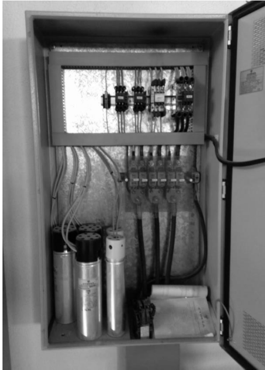
Figura 12. Batería de condensadores A2
