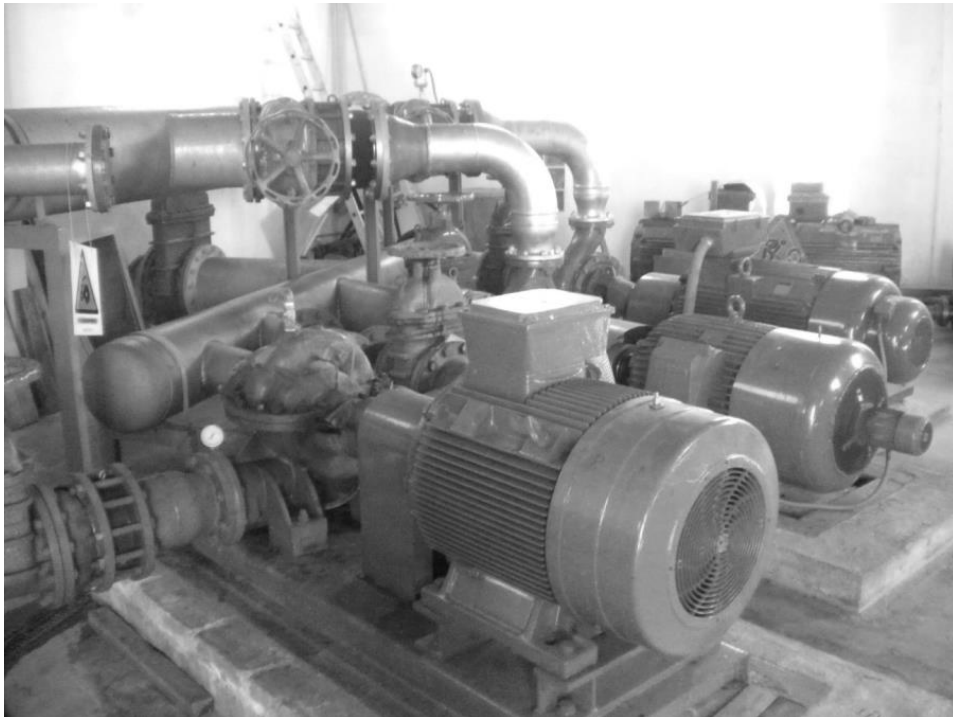
Figura 11. Sistema de bombeo de la agrupación A2
