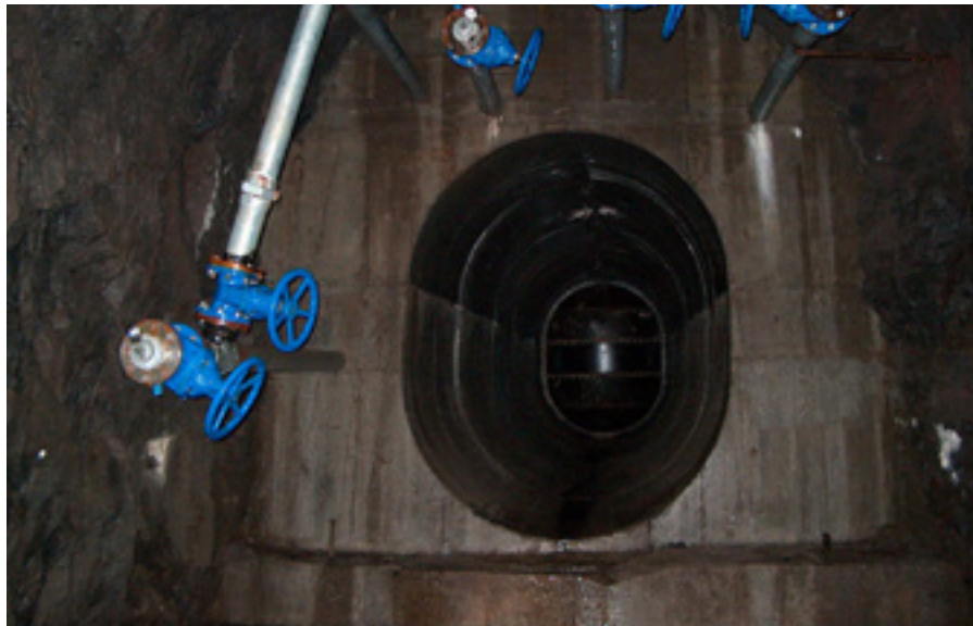
Túnel de trasvase de La Palma.
