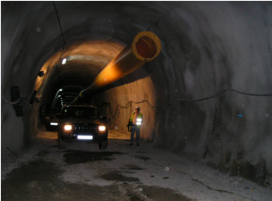
Colector-interceptor de aguas residuales, Las Palmas de Gran Canaria.
