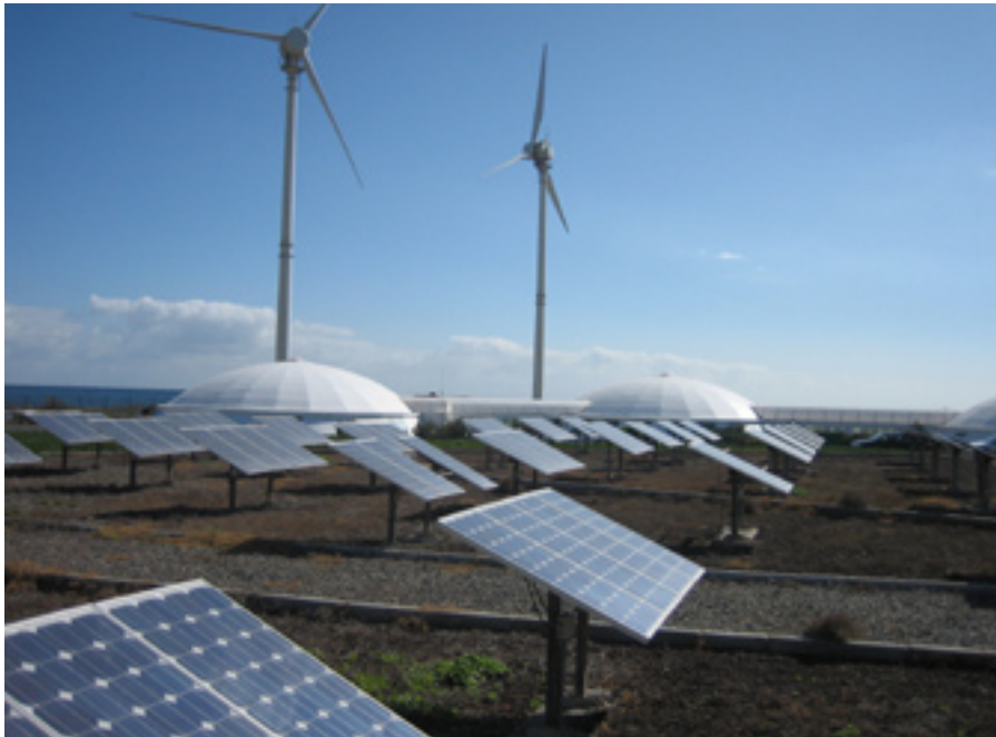
Campo Fotovoltaico del Proyecto DESSOL en Pozo Izquierdo, Gran Canaria.
