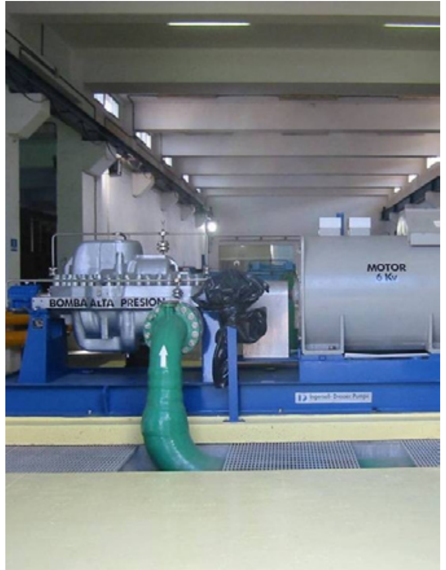
Desaladora Bocabarranco, Gran Canaria.
