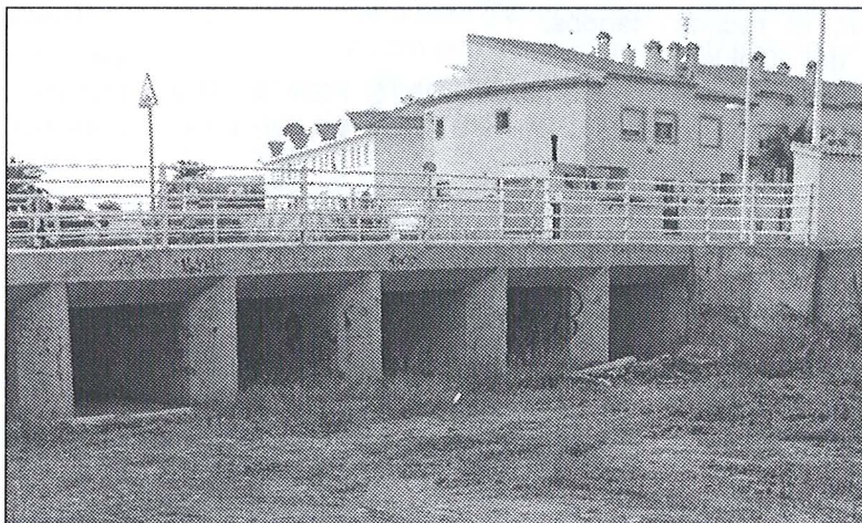
El nou pont sobre el Barranquet, promés, segueix en l'oblit i ningú dimiteix
