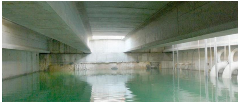
Ilustración 19: Piscina de captación de una desaladora
