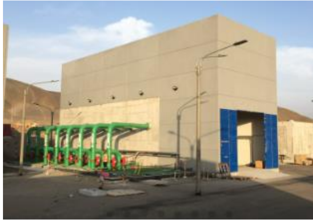
Ilustración 26: Exterior lecho de calcita rectangular de hormigón DRINTEC
