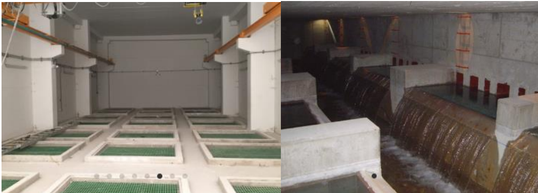
Ilustración 27: Interior lecho calcita rectangular de hormigón DRINTEC
