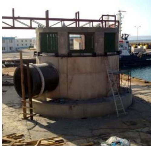
Ilustración 42: Torre de captación abierta diseñada por INCREA
