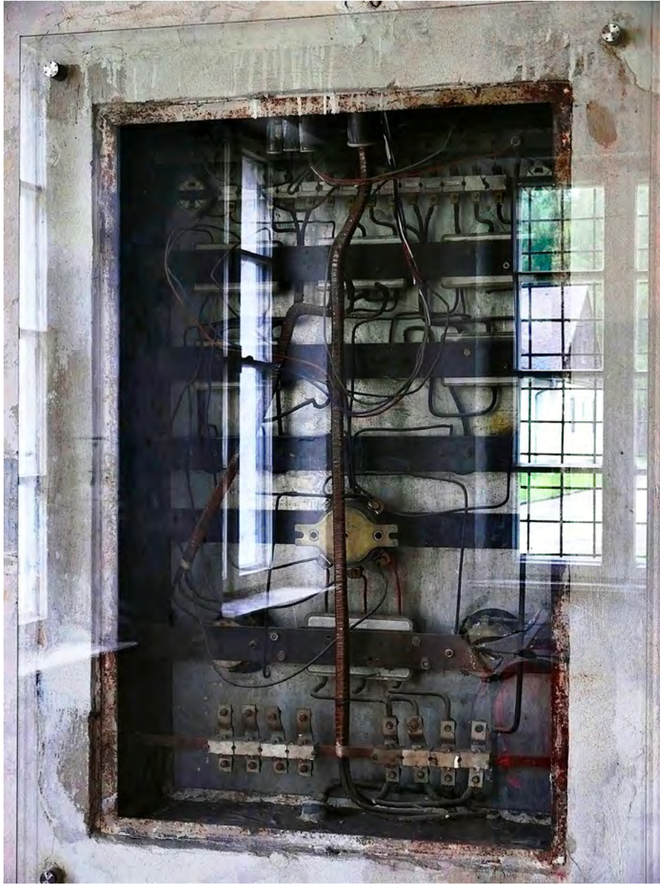
7. Dachau: dispositiu elèctric en el búnquer
