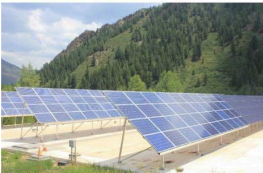
Imagen 8: Planta solar de Aspen
