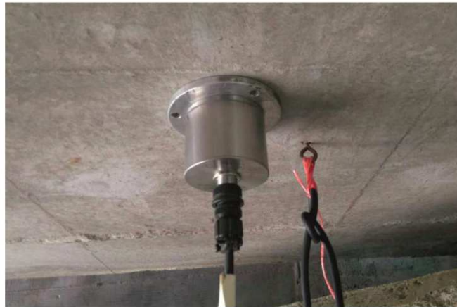
Figura 9. Acelerómetro ubicado en la cara inferior del tablero.
