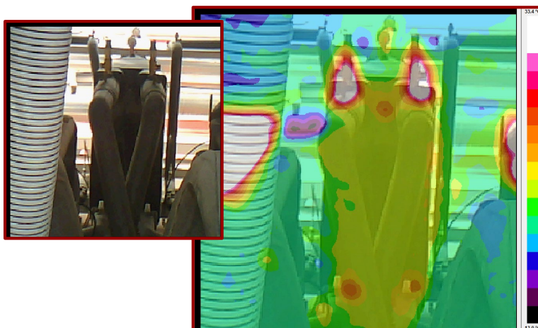
Termografia 18: intercanviador de plaques.
