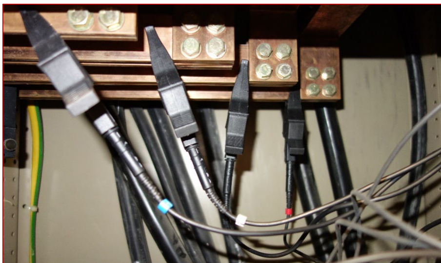
Imatge 37. Referència de tensió "cocodrils". Chauvin Arnoux PEL 103. Interior del quadre.
