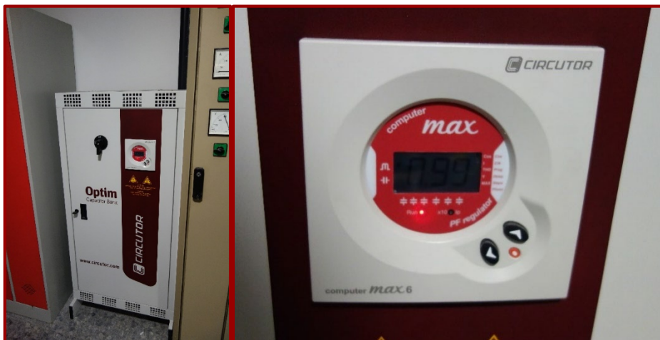
Imatge 12: Bateria de condensadors.
