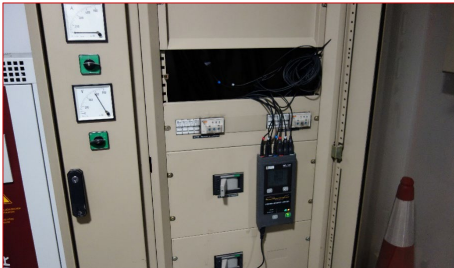
Imatge 36. Chauvin Arnoux PEL 103. Instal·lació derivació individual climatització. Mode Registre.
