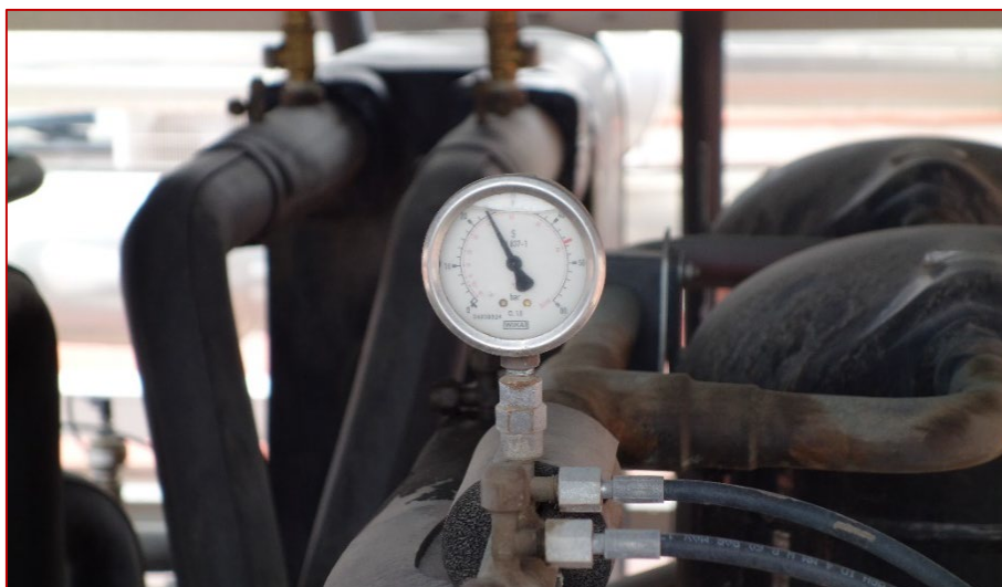
Imatge 43. Circuit d'alta pressió línia de gas. Refredadora 24 bar.
