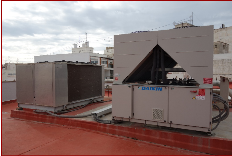
Imatge 26: Refrigeradora Daikin model EWYQ310F-XS.
