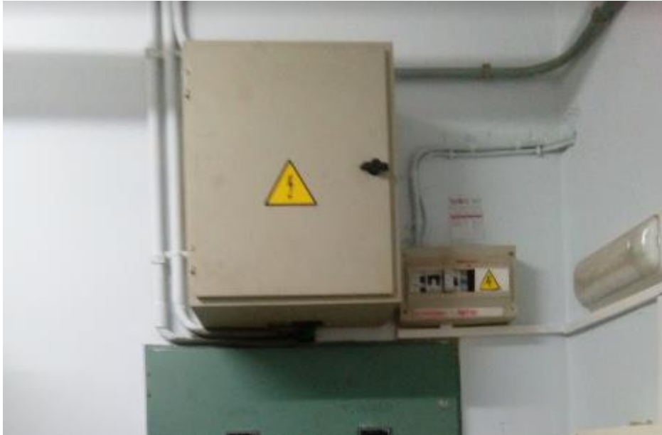
IMAGEN 5. Detalle de la batería de condensadores.
