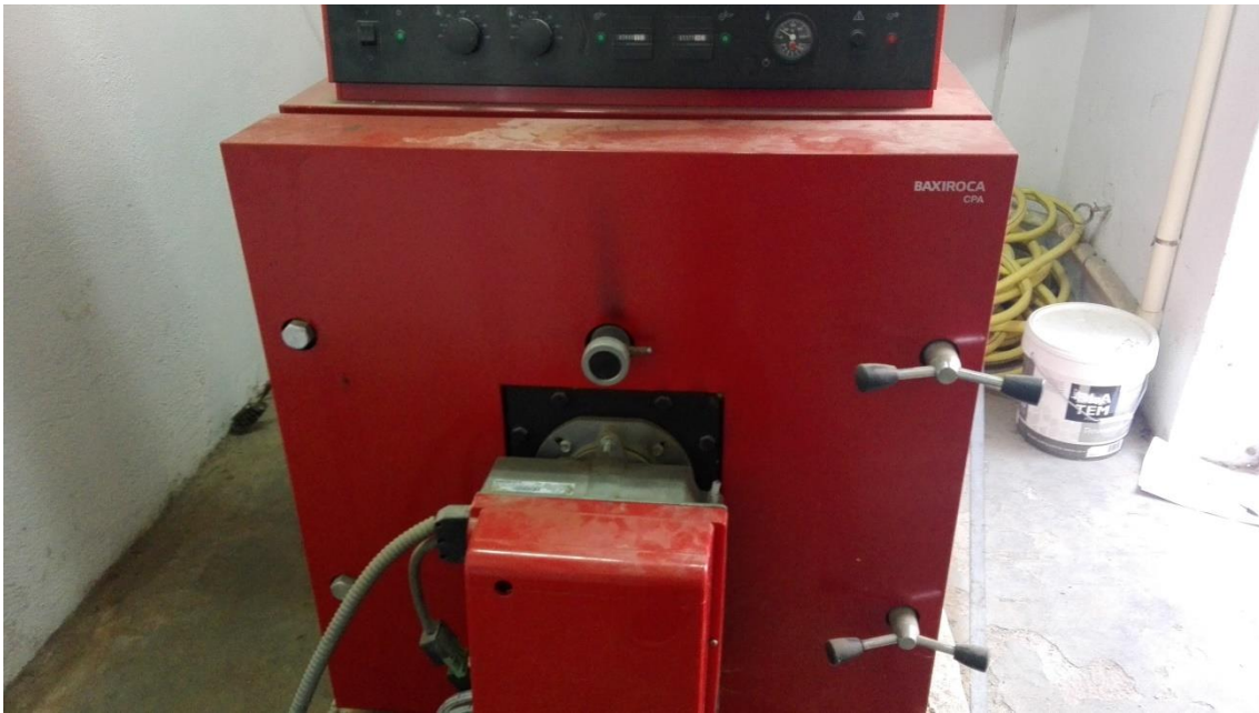
IMAGEN 8. Detalle de la caldera y el quemador.
