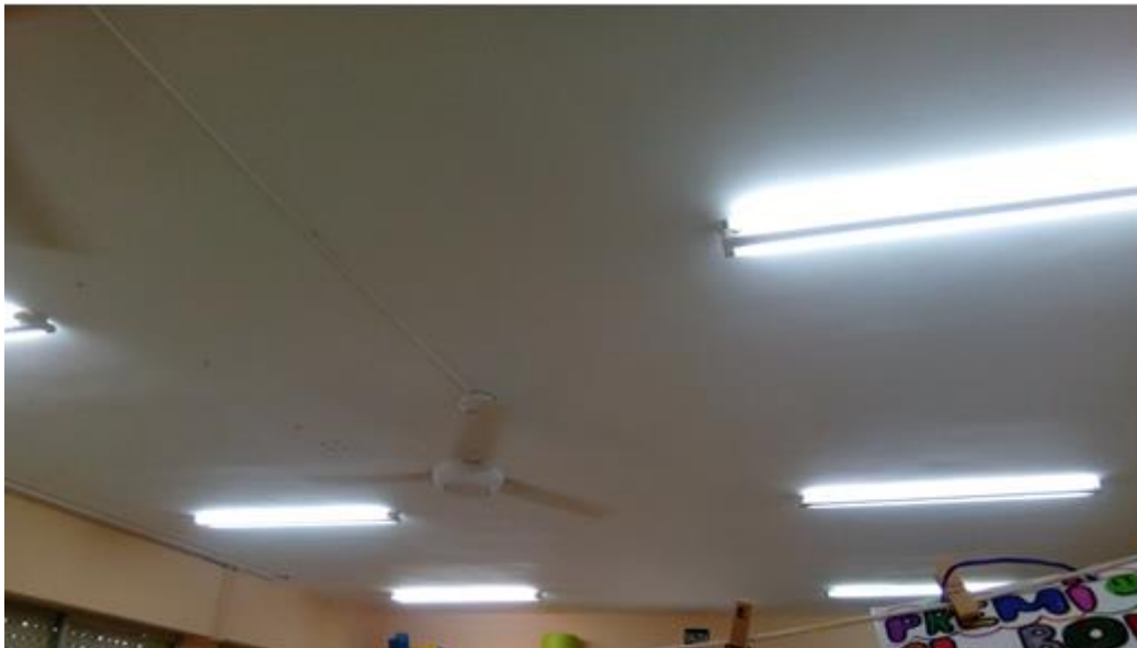
IMAGEN 6. Detalle de los tubos fluorescentes.
