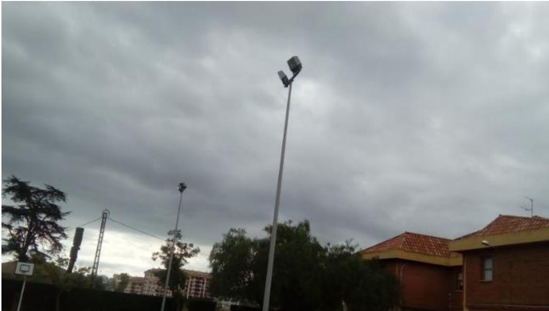
IMAGEN 7. Detalle de los focos halógenos.
