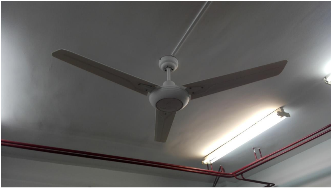
IMAGEN 14. Ventiladores de techo
