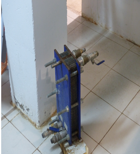
Imagen 22 – Intercambiador de placas
