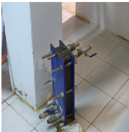
Imagen 8 – Intercambiador de placas
