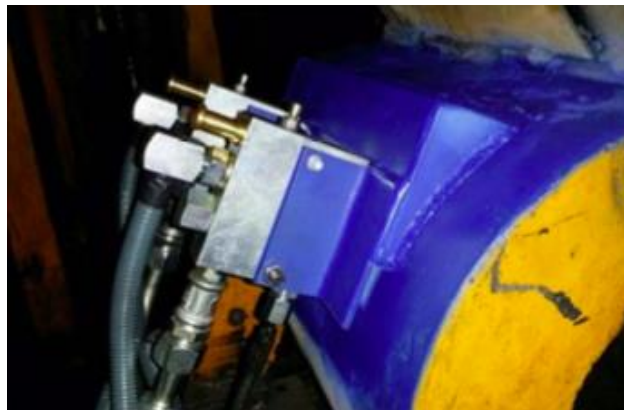
Imagen 42: Boquillas de pulverización con control instaladas.
