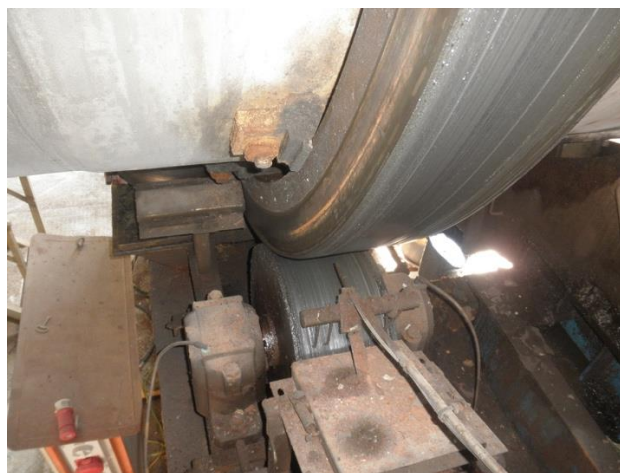
Imagen 36: Sistema de lubricación actual de los rodillos y bandas de rodadura.
