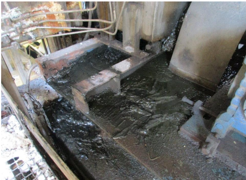
Imagen 30: Suciedad en la bancada.
