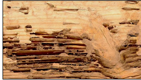
Imagen 71. Madera afectada por termitas. Imagen de Google.
