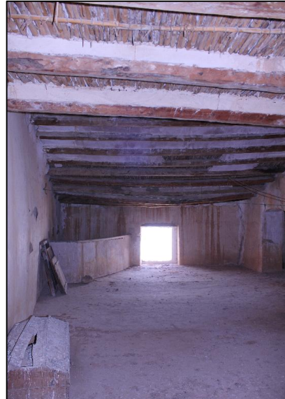
Imagen 39. Forjado deteriorado por flecha excesiva. Planta 1.
