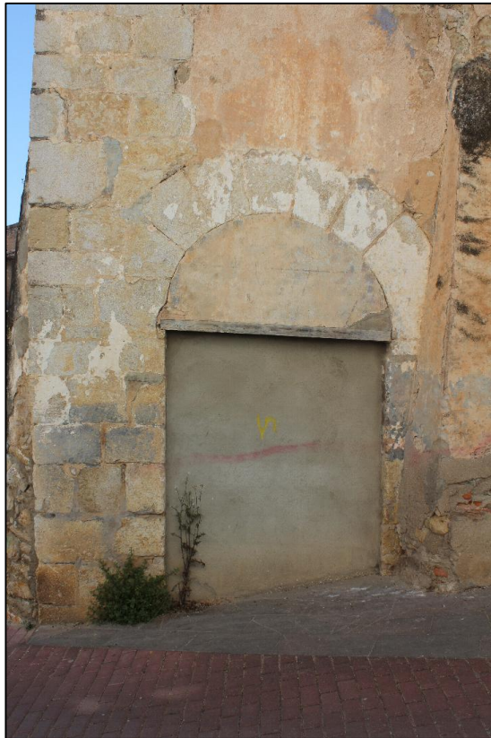
Imagen 21. Entrada a planta sótano tapiada. Calle San Joaquim
