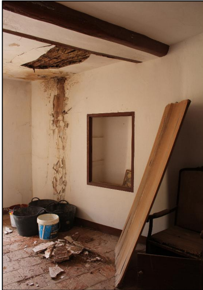
Imagen 38. Forjado deteriorado por entrada de agua. Planta 1.
