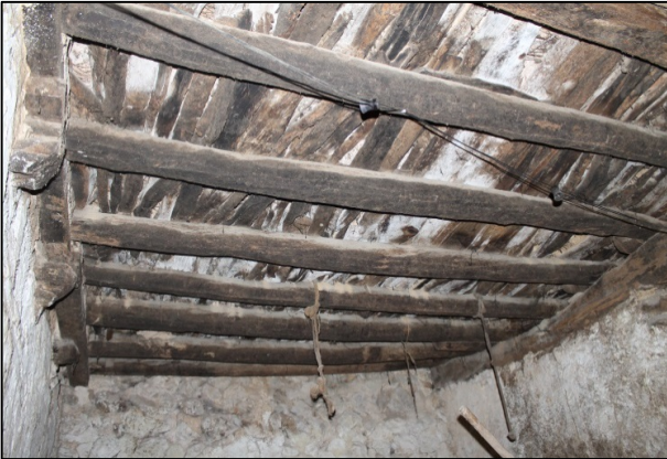
Imagen 25. Forjado de una estancia en la Planta Sótano. Forjado con tabla y rollizo.
