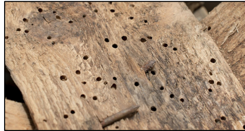
Imagen 69. Madera afectada por anóbidos. Imagen de Google.
