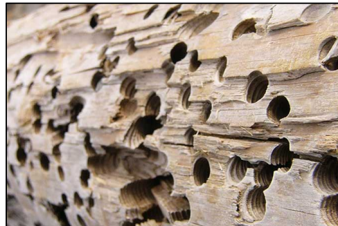
Imagen 70. Madera afectada por cerambícidos. Imagen de Google.
