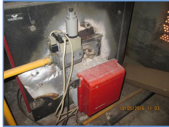
Imagen del quemador de la caldera.
