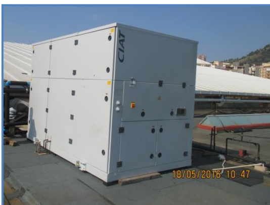
Imagen de la nueva deshumectadora de la piscina.
