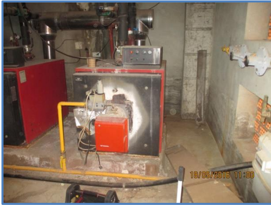
Modelo de caldera de gas existente: 360 Kw
