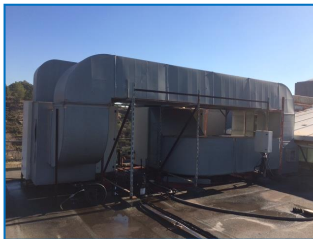
Imagen de la antigua deshumectadora de la piscina y los circuitos de impulsión y retorno.
