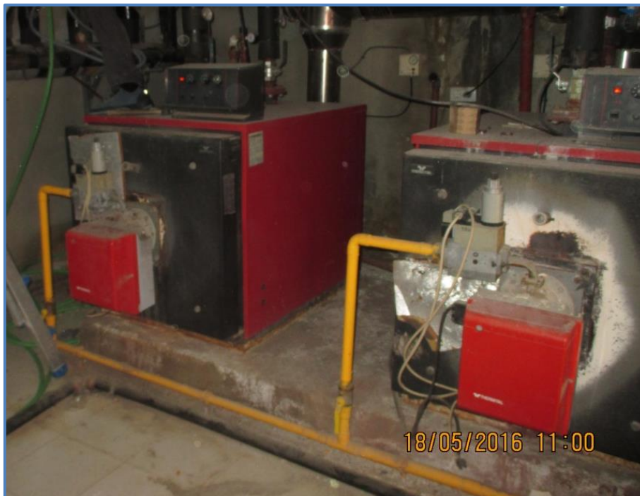
Imagen de las dos calderas convencionales de gas existentes en la instalación.
