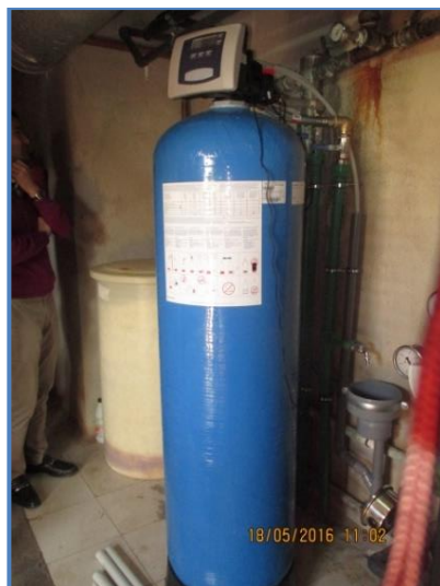
Imagen del nuevo descalcificador para el ACS de la piscina.
