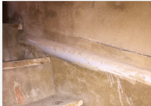
Colector de agua residual
