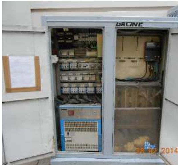
Figura A.2. Cuadro de mando y protección CM 153. Fuente: Propia, fotografía en campo.
