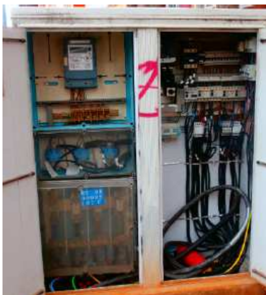
Figura A.1. Cuadro de mando y protección CM 144. Fuente: Propia, fotografía en campo.
