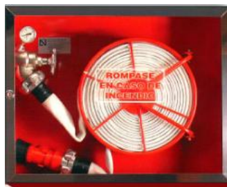
Figura 19, Boca de Incendio Equipada (BIE)
