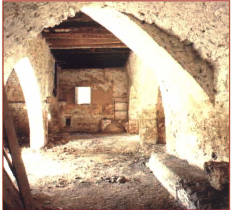
Interior del Molí de Noguera. A les imatges s'aprecia el deficient estat de conservació
