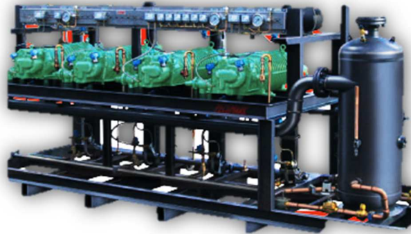
Figura 77. Banco de compresores y depósito del refrigerante
