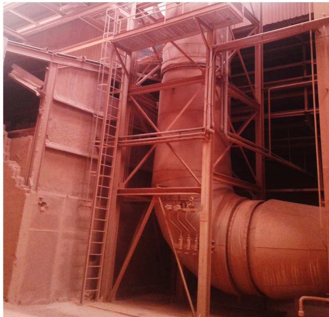
Figura 24. Conducto de los gases de escape
