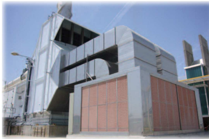
Figura 71. Sistema de enfriamiento por superficie húmeda de Munters
