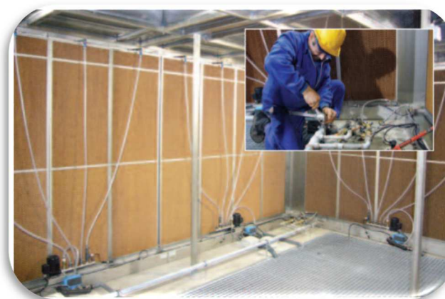
Figura 72. Interior sistema de enfriamiento por superficie húmeda de Munters
