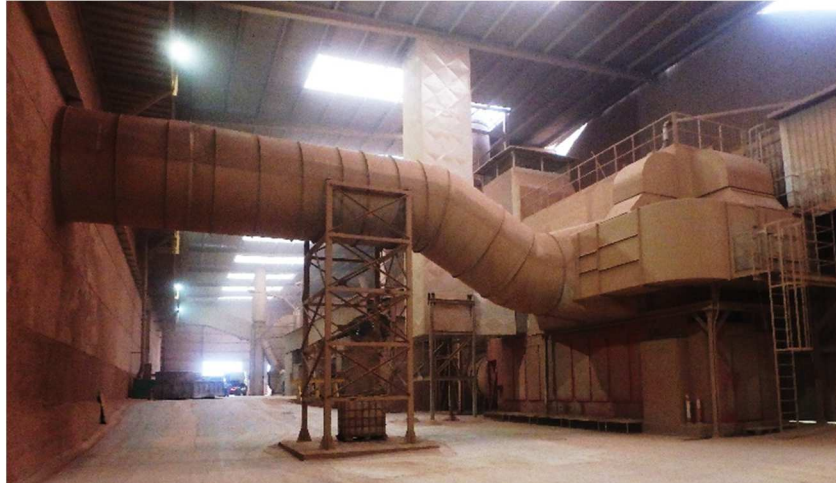
Figura 19. Planta de cogeneración
