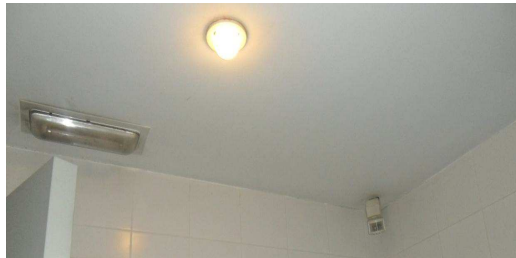
Imagen 60. Iluminación y detectores de presencia en aseos
