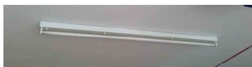
Imagen 119. Tubo fluorescente de 1x36 W en garaje interior, sala de caldera y aparcamiento exterior
