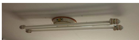
Imagen 118. Tubos fluorescentes de 2x36 W en cocina
