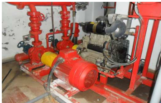
Imagen 61. Bomba contra incendios
