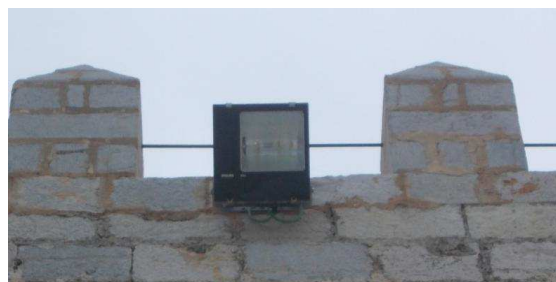
Imagen 101. Proyector de halogenuro metálico en exterior
