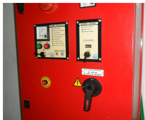
Imagen 63. Armario control de bomba contra incendios
