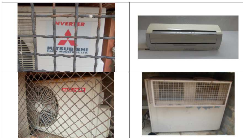
Imagen 95. Equipos de climatización del Castillo de Peñíscola
