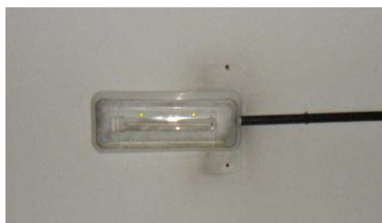
Imagen 56. Alumbrado emergencia de garaje
