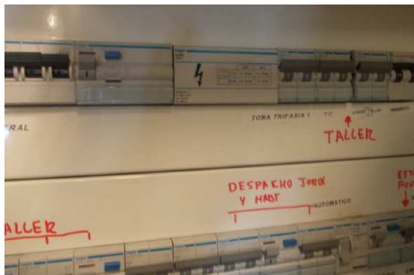
Imagen 104. Subcuadro del almacén y del taller
