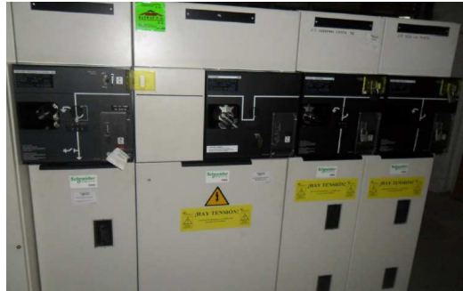
Imagen 64. Celdas de protección, medida y seccionamiento
