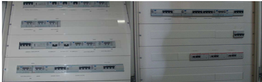
Imagen 103. Cuadro General de baja Tensión
