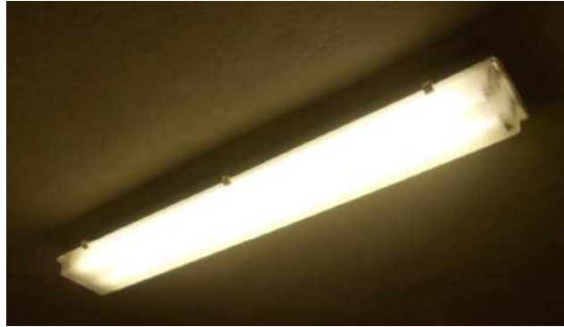
Imagen 96. Pantalla de tubos fluorescentes de 36 W del almacén eléctrico y taller, iglesia y aseos
