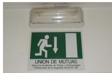
Imagen 57. Alumbrado emergencia pasillos
