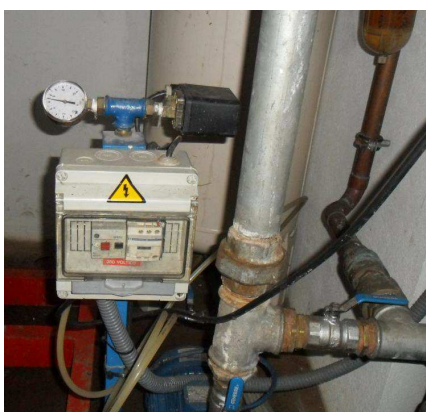
Imagen 62. Cuadro contra incendios
