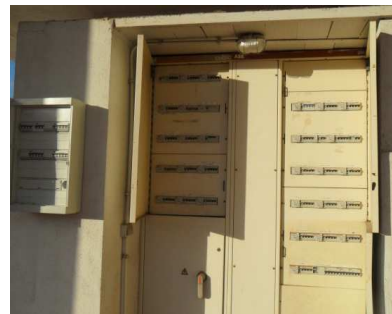
Imagen 73. Cuadro equipos de A/A
