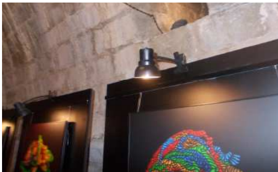
Imagen 99. Lámparas fluorescentes compactas de 9 W en expositores
