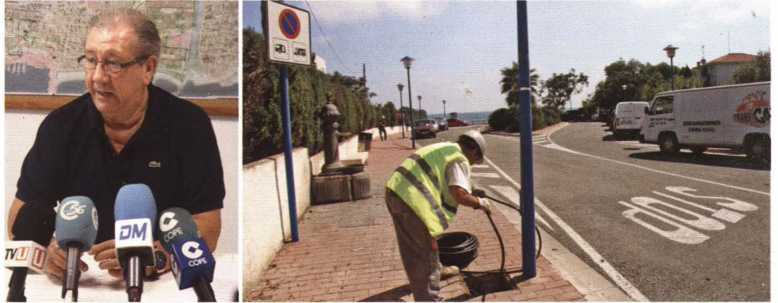
La brigada de servicios está trabajando para reparar cuanto antes los daños causados por el robo de cable
