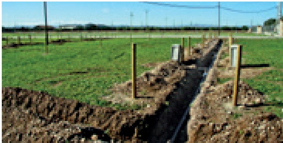
En los huertos, situados en el Pou de Mangrano, se está procediendo a la instalación del agua potable y la delimitación de las parcelas
