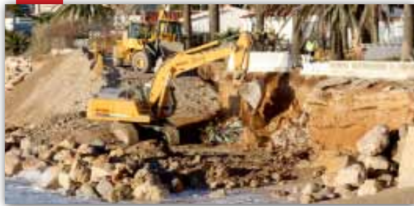
Costes actua en l'erosió de Cala Puntal
