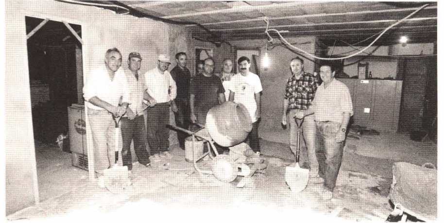
El presidente, Rafael Calvo y un grupo de socios haciendo obras de reforma. Foto: Difo's
