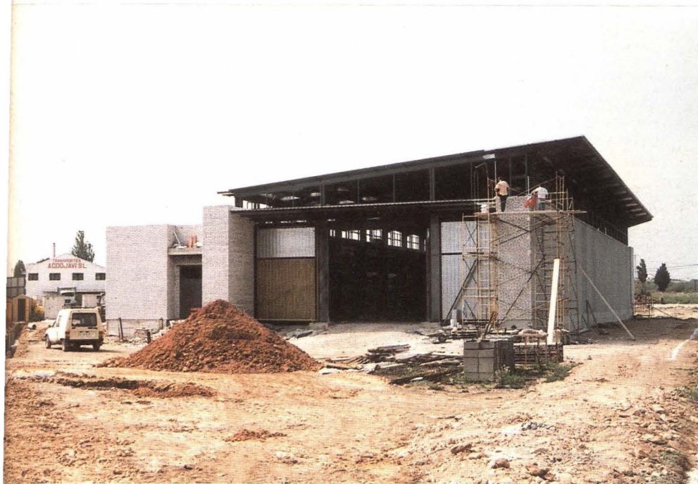
Les instal·lacions de l'ITV quasi a punt. Foto: Reula
