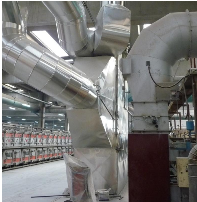
Figura 4.3. Intercambiador de calor en industria.
