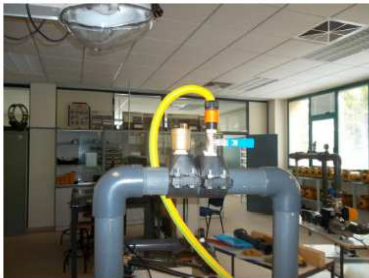
Figura 30: Entrada de agua y purgador automático.
