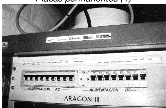
Etiquetas en los equipos instalados
